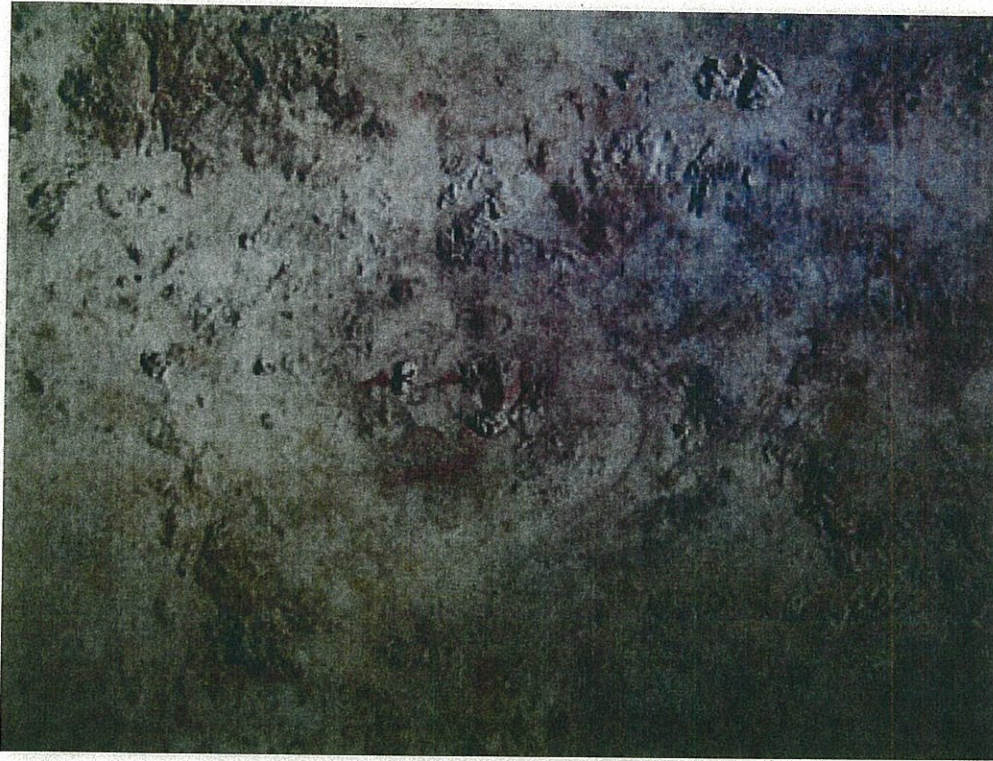
写真 2 - 5 漆喰層内部が中空化し、陥没
