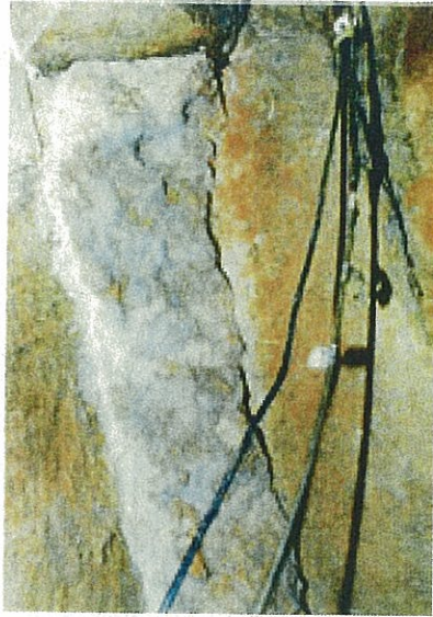
写真 1-1 取合部のカビの発生状況 (平成 13 年 3 月)
