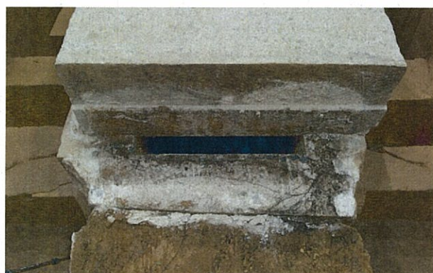
図 25 石室石材の接合面に確認されたカビ等の汚れ（北壁石上面）
