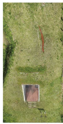
保護盛土亀裂部
