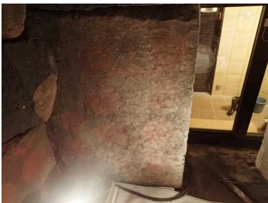
図 8 永安寺東古墳石室カビ発生状況
