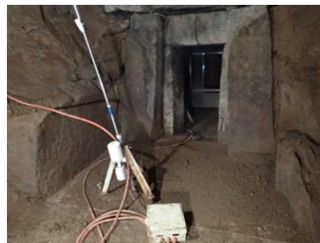
図 12 H31.1.3 地震時崩落状況
