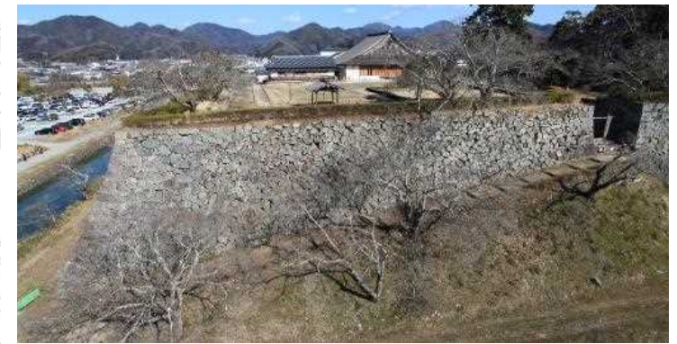
(危険個所が見つかった二の丸南西石垣)
